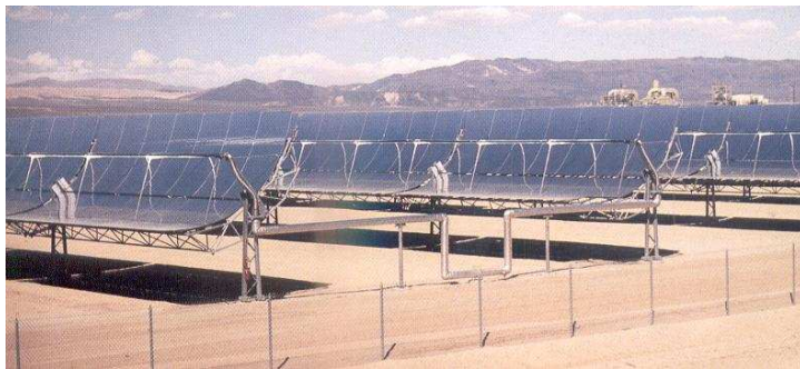
Centrale à concentrateurs cylindro-paraboliques, http://sycomoreen.free.fr/syco_francais/solaire_thermoelec_artactuel.html
